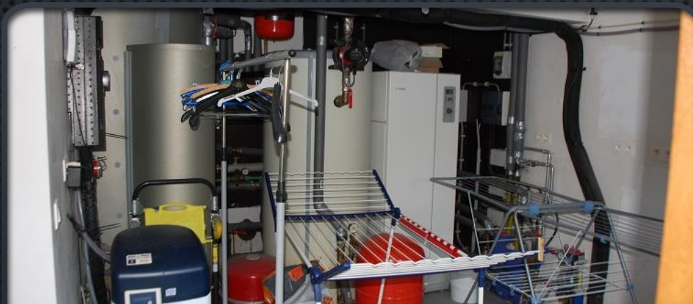
warmtepomp, zonneboiler en regenpompen
